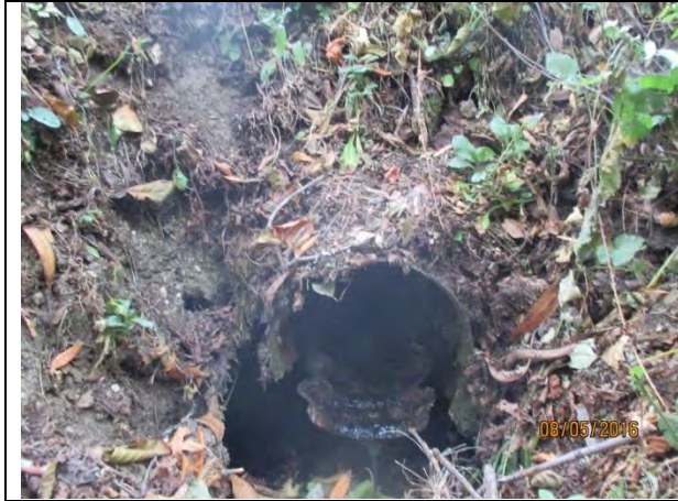
Photo 2. 1.5 Alpine culvert outlet (August 2016).
