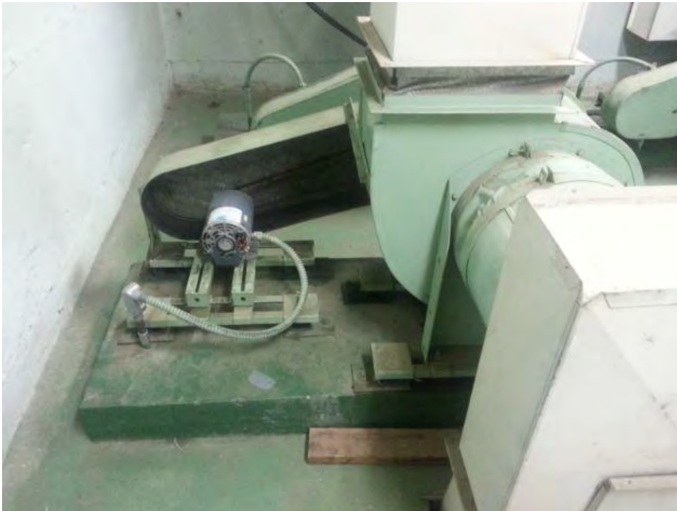
Photo M-7 – Exhaust Fan
